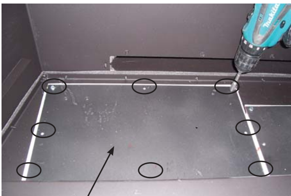
Fan Access Panel
