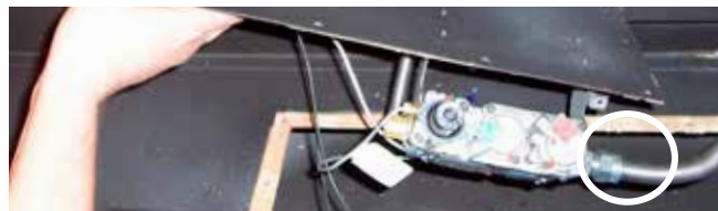
Conduite d'alimentation en gaz
