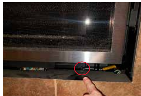
Ce commutateur Surefire est situé dans le centre inférieur droit, derrière la paroi avant.
