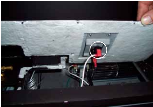
l'alimentation en gaz
