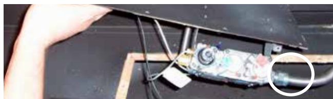
Conduite d'alimentation en gaz
