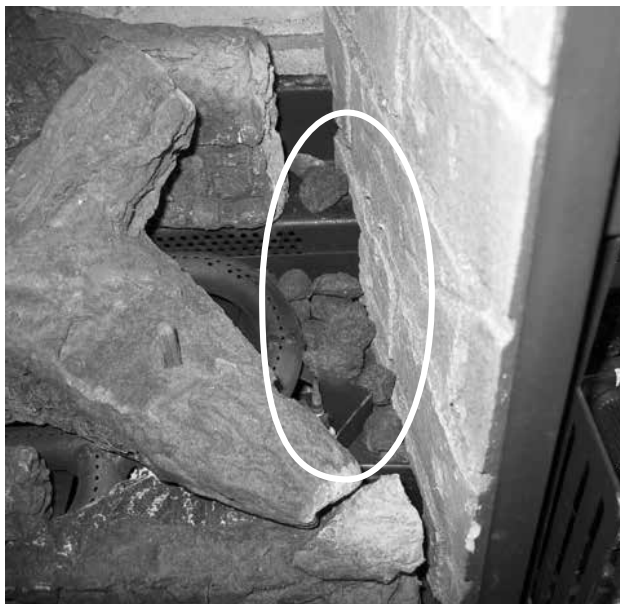
Côté droit du brûleur
