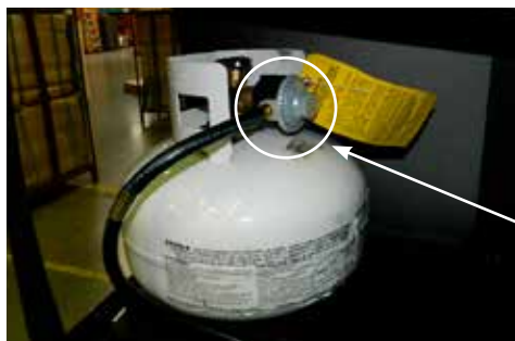
Raccordement du gaz à la bouteille
