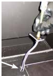
Fils du dispositif d'éclairage
