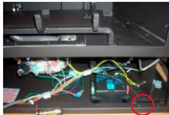
Le commutateur Surefire est situé sur le coin droit de la grille d'aération/du panneau inférieur.
