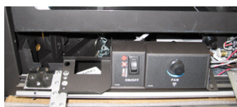
Commutateur du brûleur attaché au grille d'aération inférieure.
